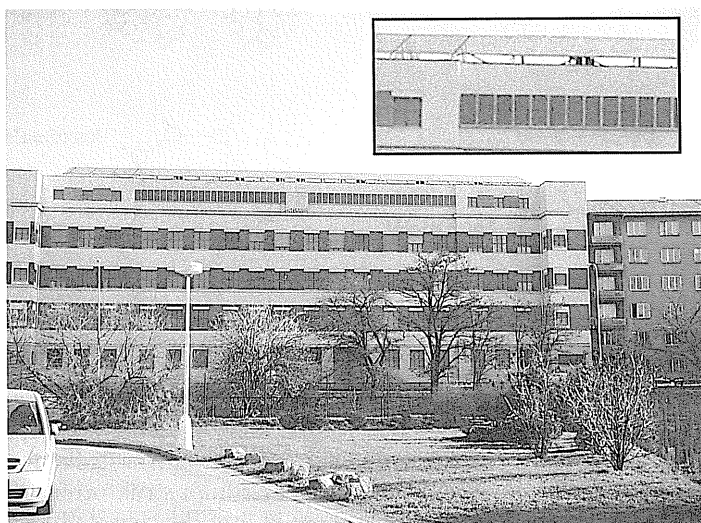
Obr. 4 Fotovoltaický systém na budově PdF MU v Brně, Poříčí 31
