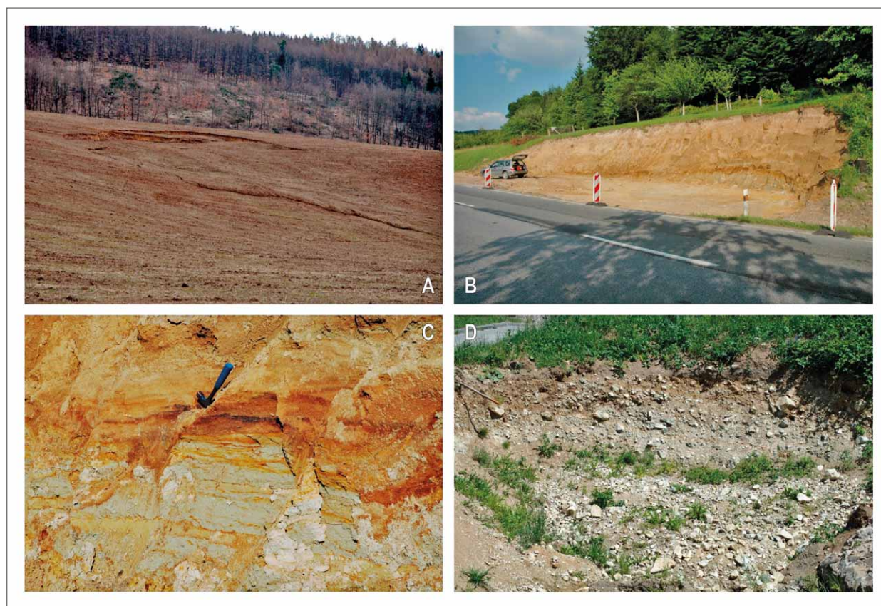
Obr. 2: A – Celkový pohled na sesuv č. 24-32-04/4a po jeho vzniku v roce 2006 v Milonicích u Lipůvky, délka sesuvu 120 m, šířka 75 m; B – Pohled na odkryté čelo sesuvu č. 24-14-24/6 po jeho vzniku v roce 2006 v Závisti, šířka odkrytého zářezu je 50 m; C – Litologický profil sedimenty otttangianu v čele sesuvu č. 24-14-24/6 v Závisti; D – Ostrohranné hrubě klastické sedimenty otttangianu v čele sesuvu č. 24-34-04/2 v Lažanech, šířka snímku je asi 3,5 m.
