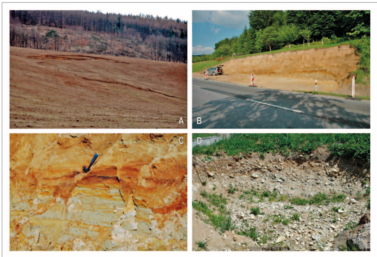
Obr. 2: A – Celkový pohled na sesuv č. 24-32-04/4a po jeho vzniku v roce 2006 v Milonicích u Lipůvky, délka sesuvu 120 m, šířka 75 m; B – Pohled na odkryté čelo sesuvu č. 24-14-24/6 po jeho vzniku v roce 2006 v Závisti, šířka odkrytého zářezu je 50 m; C – Litologický profil sedimenty ottנגangu v čele sesuvu č. 24-14-24/6 v Závisti; D – Ostrohranné hrubě klastické sedimenty ottנגangu v čele sesuvu č. 24-34-04/2 v Lažanech, šířka snímku je asi 3,5 m.
