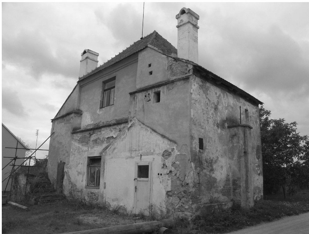
Obr. 14. Poničená a vzhledově zcela změněná budova původní věže se vstupní bránou z r. 1619. Foto: P. Čermáková.
