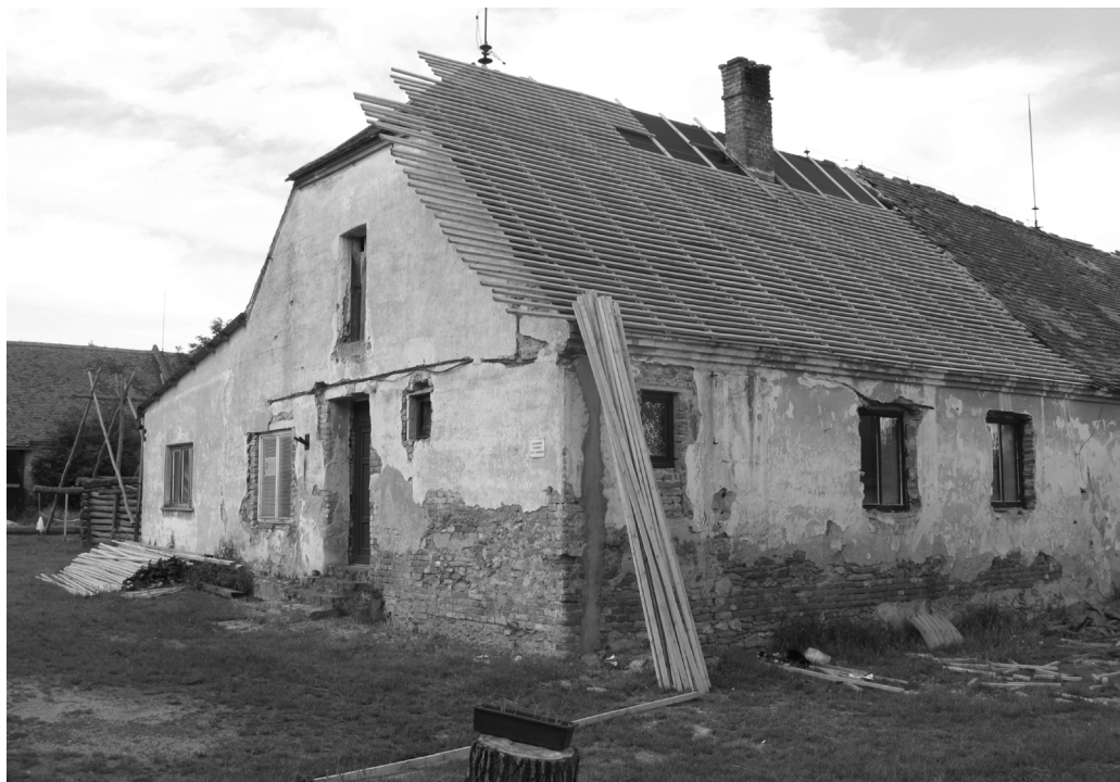
Obr. 4. Výměna staré, propadené střechy na rodinném domě, dnes studentské části expedice – ubytovně. Foto: B. Klíma.
